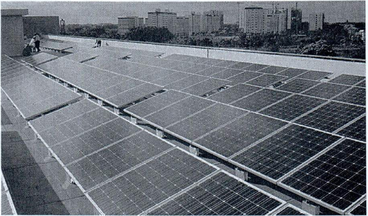
Hình A.2. Điện mặt trời mái nhà chung cư (ảnh minh họa)
